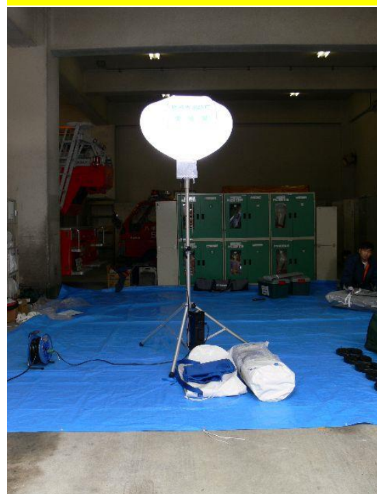
夜間照明を装備
