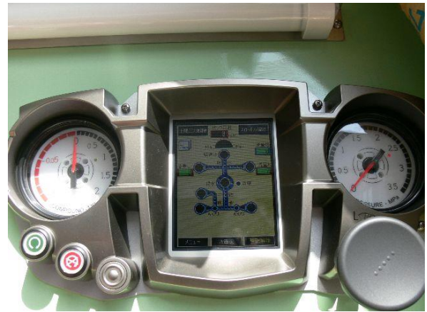
放水ポンプ操作盤・液晶パネル付き。
